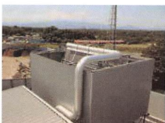
蒸気復水器 タービン排気をファンで冷却し水に戻します。
