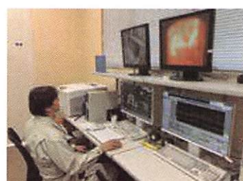
中央制御室 ボイラー及びタービン発電機その他補機類を管理制御します。
