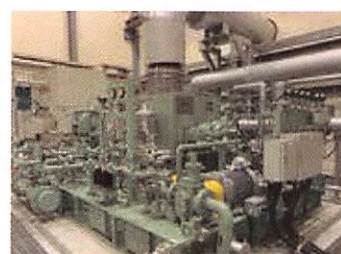
蒸気タービン・発電機 ボイラーから発生した蒸気を利用して発電を行います。
