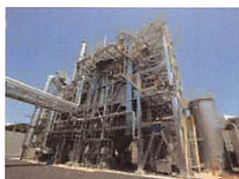
トラベリングストーカボイラー 燃料を燃焼させて蒸気を発生させます。
